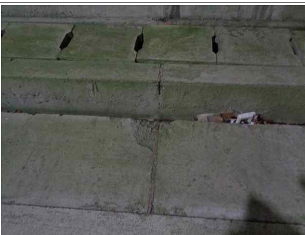
포장부 S43 갯길측 파손-서울방향
