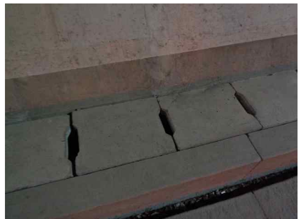
공동구 S39 뒹개 파손-서울방향
