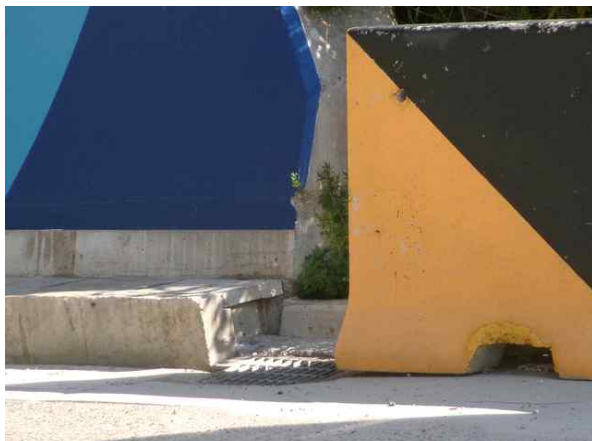
시점측 갭문 파손-문산방향
