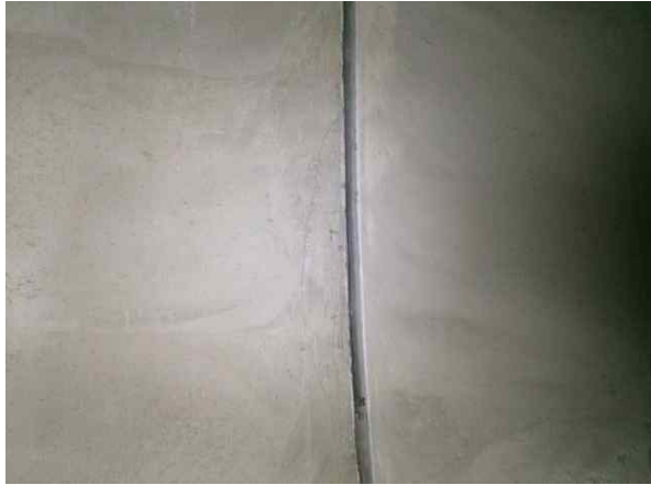
라이닝 S14 천단부 균열( C_w=0.3\text{mm} 미만)-서울방향
