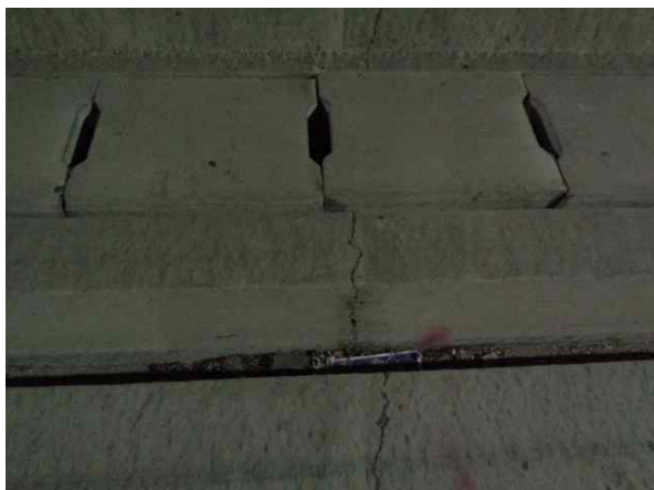
공동구 S20 균열( Cw=0.3\text{mm} 이상)-서울방향
