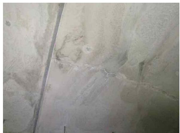
라이닝 S15 천단부 백태-문산방향
