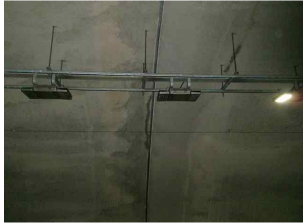
라이닝 S20 천단부 조인트부 들뜸-문산방향
