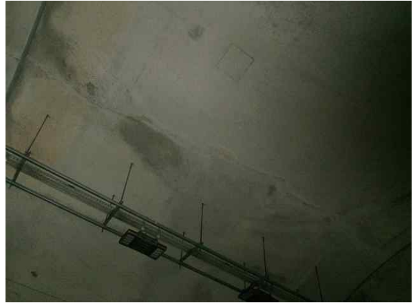
라이닝 S24 천단부 균열( C_w=0.3\text{mm} 이상)-서울방향
