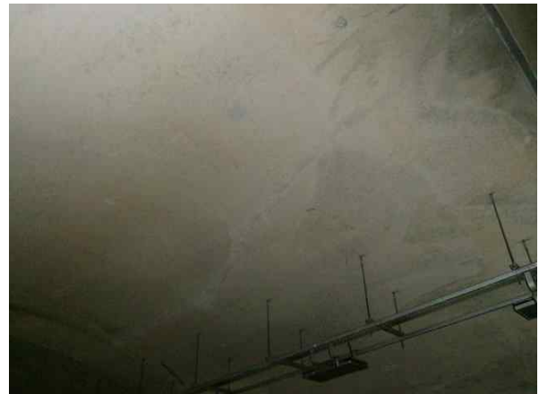
라이닝 S21 천단부 균열(Cw=0.3mm미만)-문산방향
